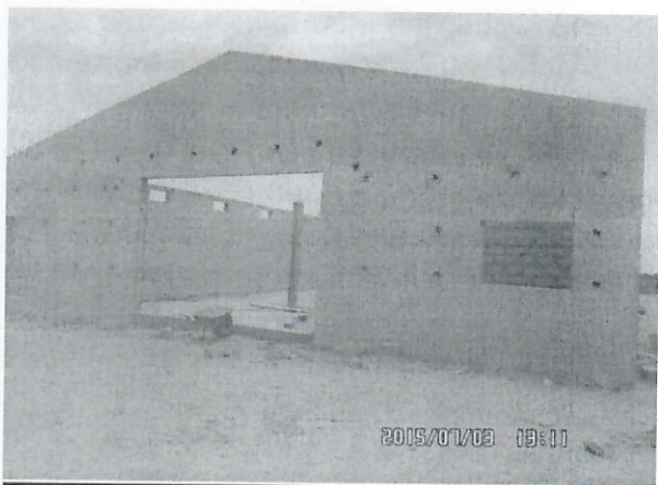
Figure 13 : Le hangar de 500 m 2 au stade d'élévation de la fabrique d'aliment de poisson de Ndiar
