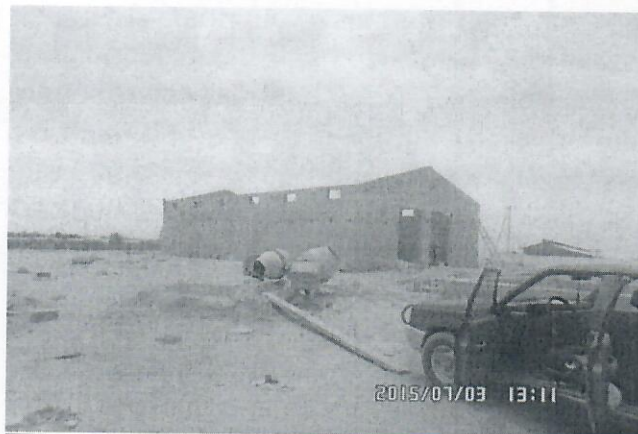
Figures 14 : Le magasin de 200 m 2 avec l'installation des gros œuvres (semelles) en cours
